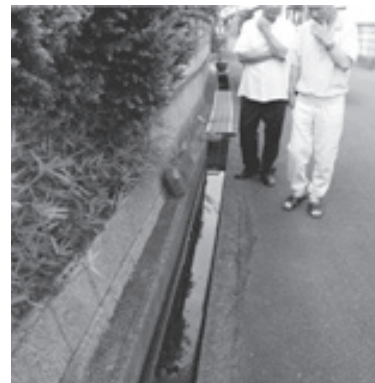
汚でいにより悪臭を発する側溝
